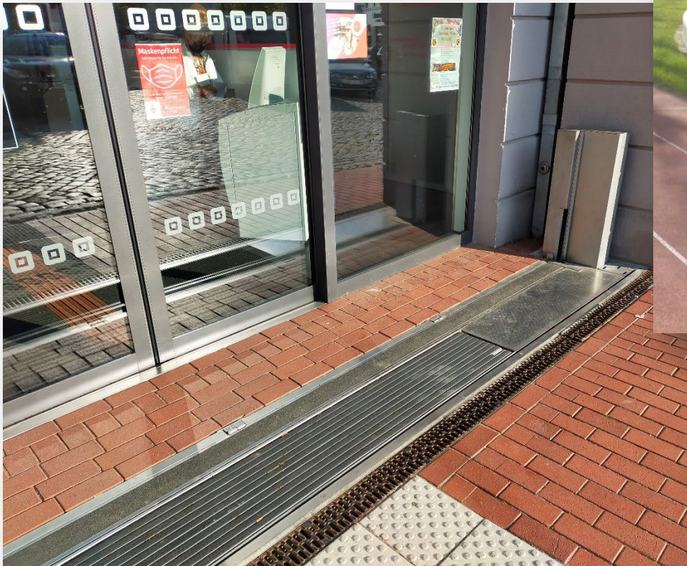
Links: Hochwasserschutzanlage an der Sparkasse Rechts: Hochwasserschutzanlagen am Gymnasium
